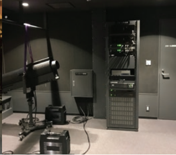
ネットワークラック
