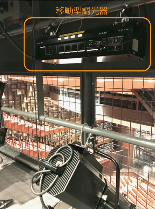
シーリングライト給電部
