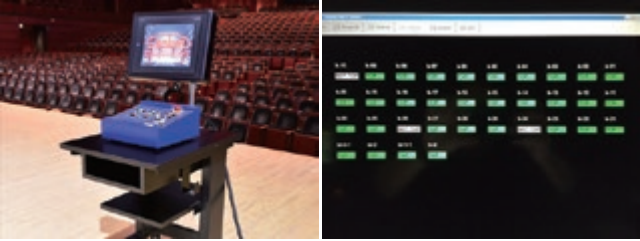
音響反射板用操作盤 インターロック表示 (CAT192)
