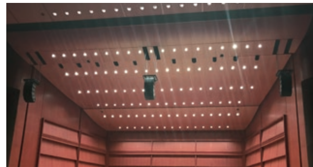
プロセニウムスピーカー 天井露出状態
