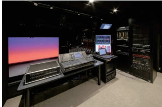
久留米座 音響調整室
