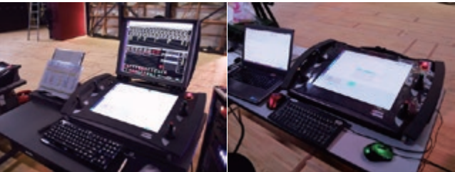
主操作卓【CAT192】と副操作卓兼バックアップ操作卓【CAT190】
